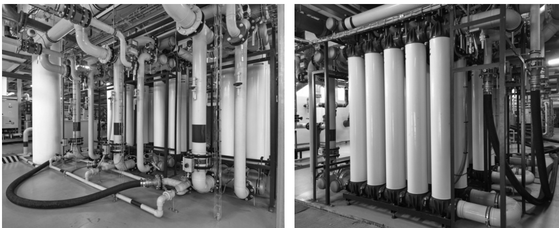
Obr. 1. Jednotka UF v Energy Ústí nad Labem, a.s.
